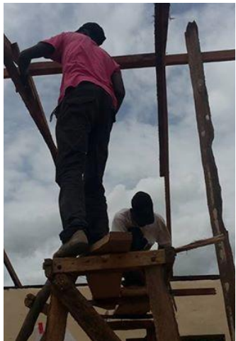
Het dak van de school stond op instorten en moest snel vernieuwd worden.
